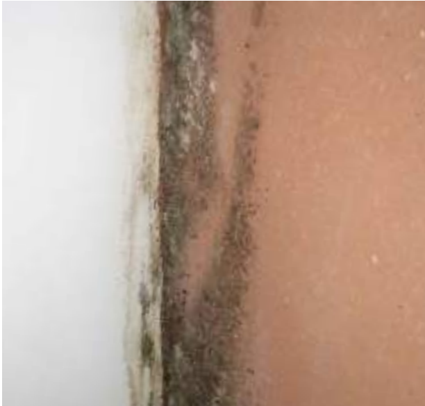
13. Moisissures sur enduit chanvre/chaux suite à infiltration pluie dans mur existant
