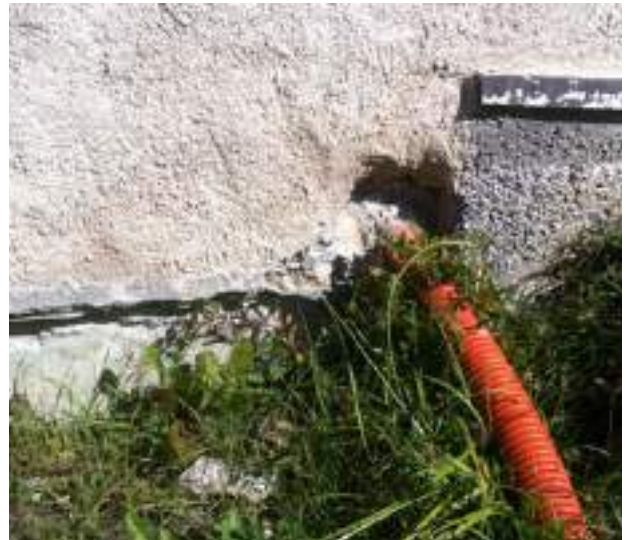
16. Pied de mur non conforme aux RP
