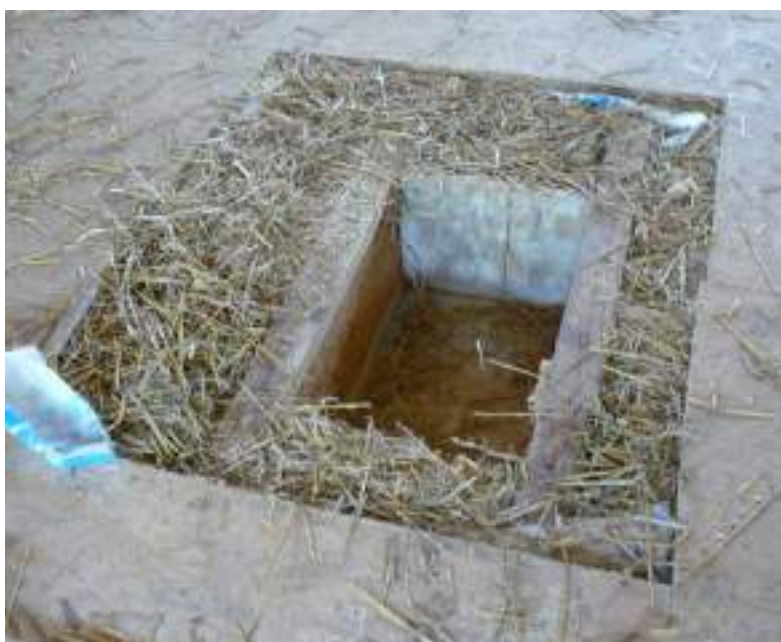
2. Traces d'humidité sur la paroi et dans le fond du caisson
