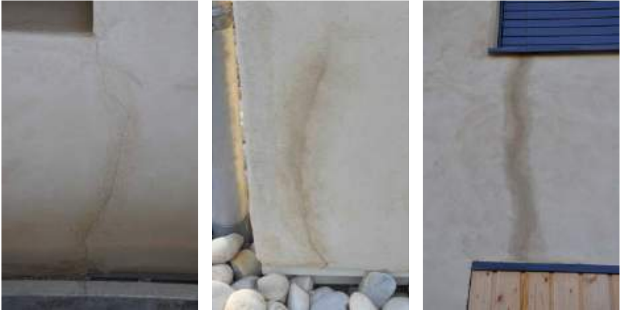
3.4.5. Fissuration d'un enduit chaux sur une isolation en paille
