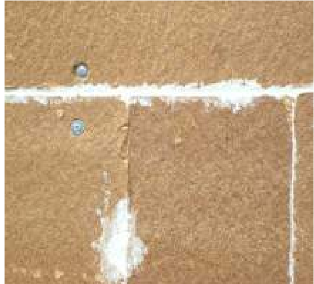
22. Joints silicone entre panneaux de fibre de bois : risque de ponts thermiques
