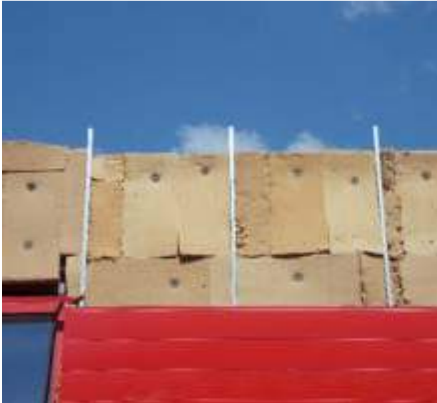
21. Mise en œuvre fantaisiste d'un isolant en fibre de bois : risque de ponts thermiques
