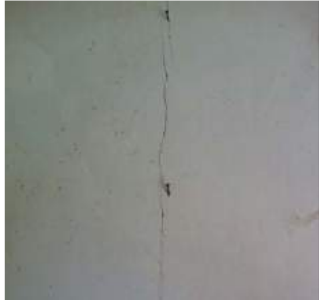
14. Fissuration au droit d'un poteau de structure suite à un défaut d'enrobage
