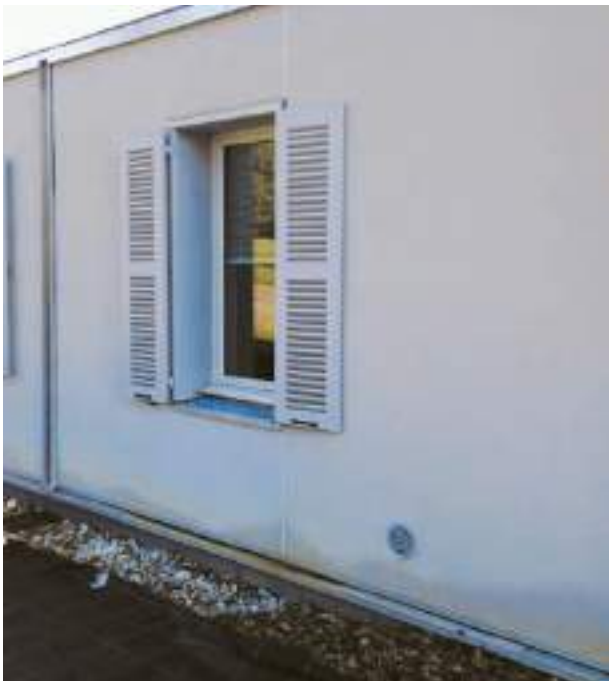
6. Enduits exposés au nord présentant de l'humidité une bonne partie de l'année
