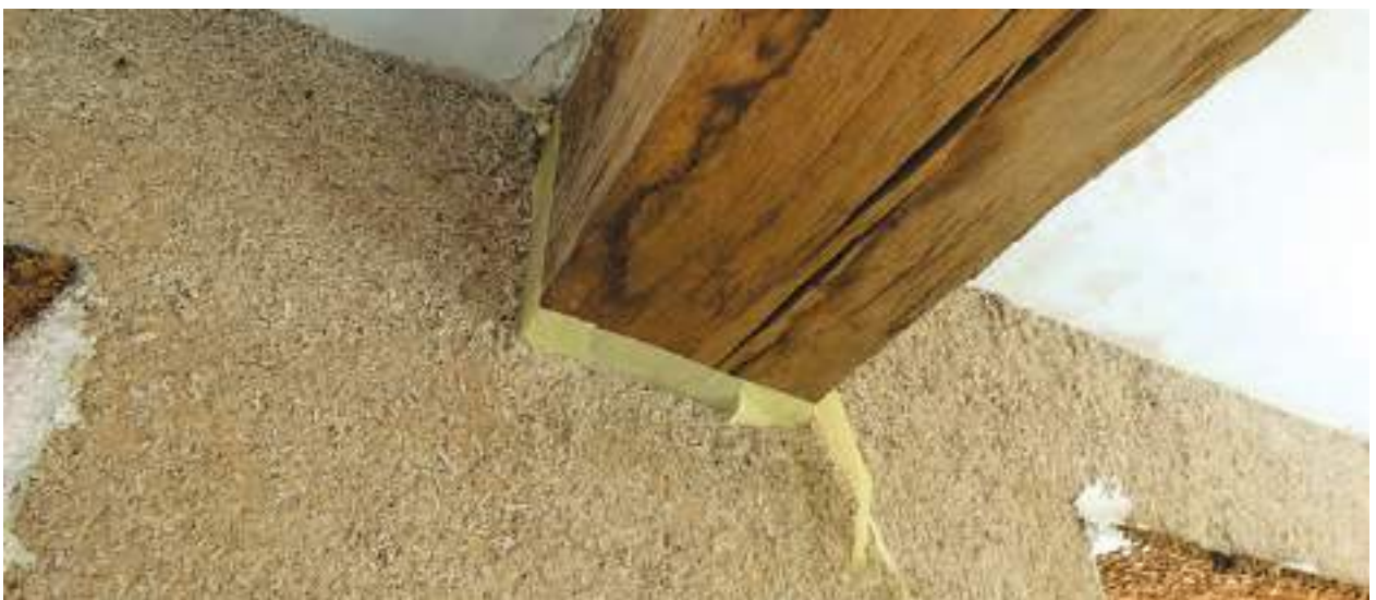
17. Noircissement d'une poutre apparente suite au contact avec la chaux.
