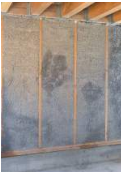
25. Développement de moisissures sur une façade orientée au nord
