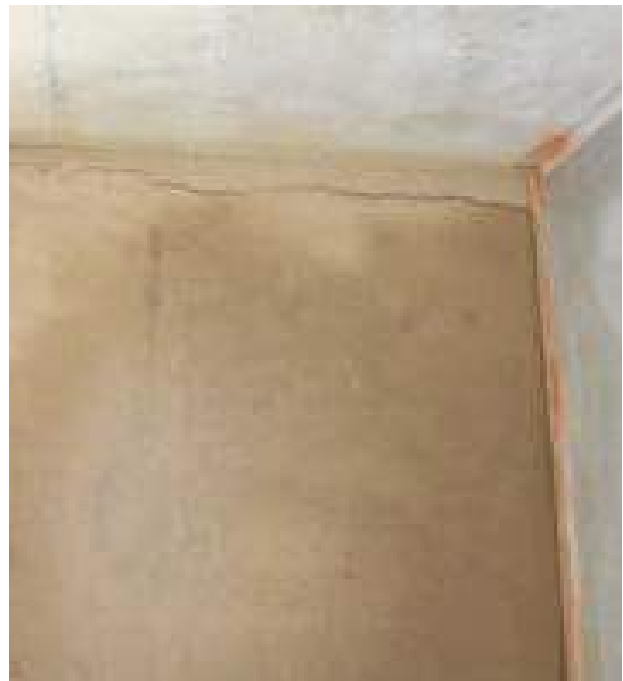
7. Enduits terre sur isolant paille : conditions et temps de séchage inappropriés
