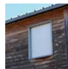
Bardage bois sans finition : vieillissement d'aspect après 15 ans d'exposition
